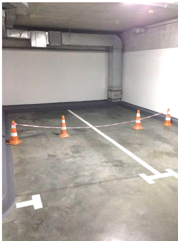
Рис. 2. Загальний вигляд верхньої частини плити перекриття в паркінгу будівлі в осях А-Б/8-9
